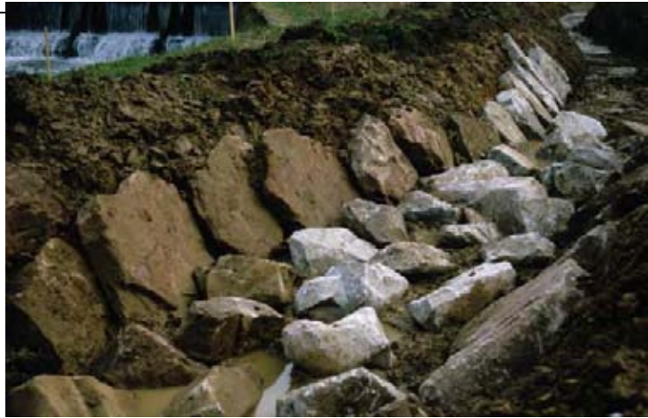
Abb. 19: Ufersicherung im Gerinne mit schuppenartig überlappenden Seitenblöcken (Blick nach oben)
