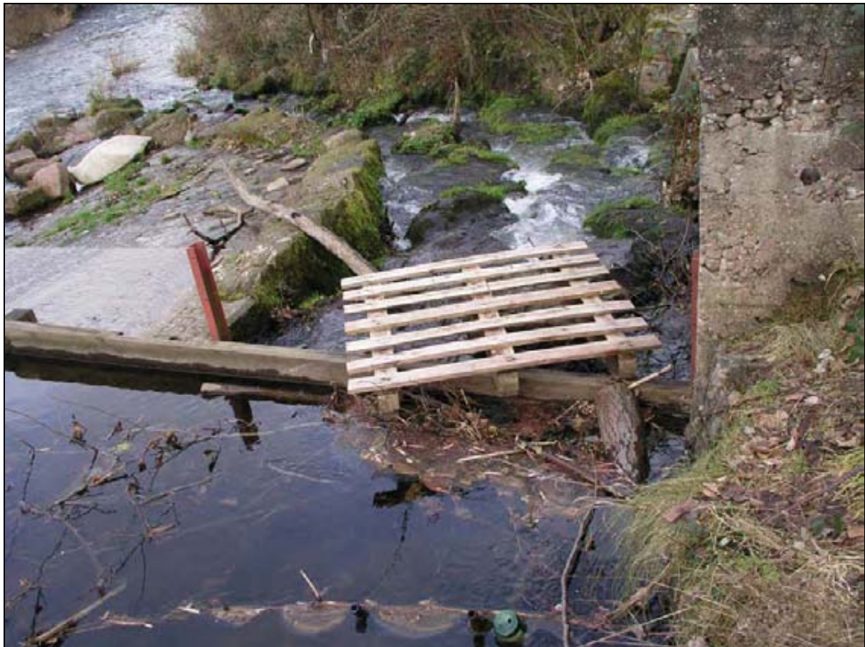
Abb. 32: Stark verlegter Einlaufbereich eines Gerinnes
